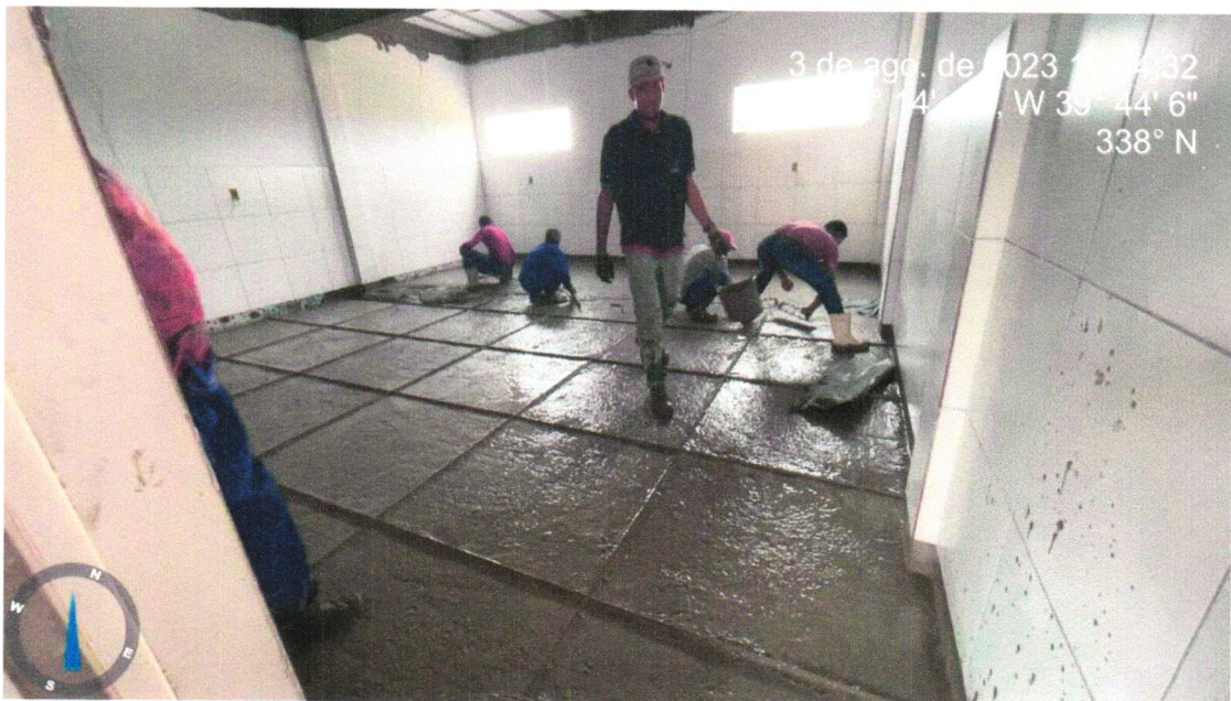
Foto 10 – Piso alta resistencia, cor cinza, e=10mm, aplicado com juntas, polido até o esmeril 400 e encerado, exclusive argamassa de regularização
