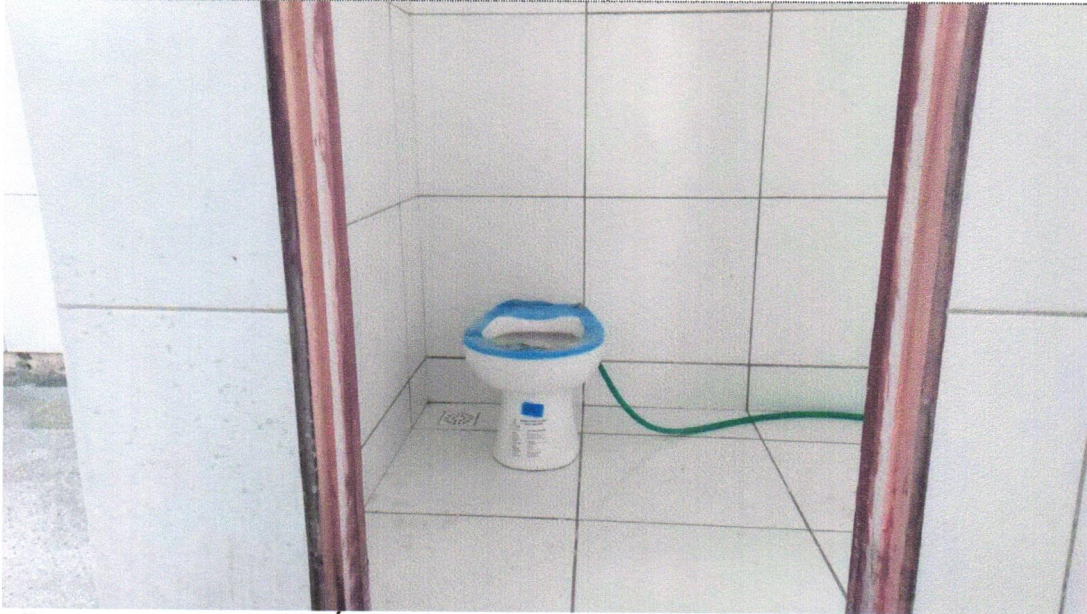
Foto 20 – VASO SANITÁRIO INFANTIL LOUÇA BRANCA - FORNECIMENTO E INSTALACAO. AF_01/2020.
