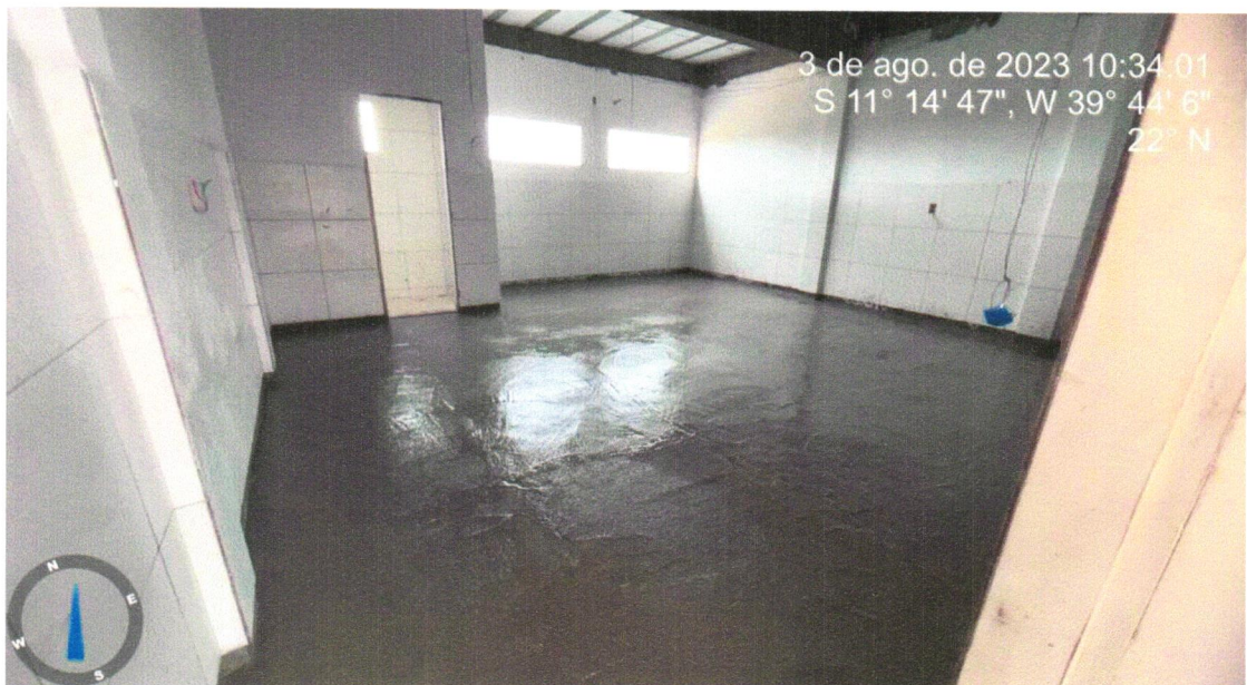
Foto 12 – Piso alta resistencia, cor cinza, e=10mm, aplicado com juntas, polido até o esmeril 400 e encerado, exclusive argamassa de regularização
